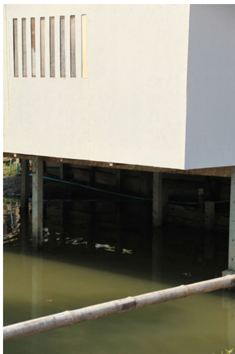
ภาพที่ 4.15 บริเวณที่มีน้ำเน่าขังใต้ถุนบ้าน
