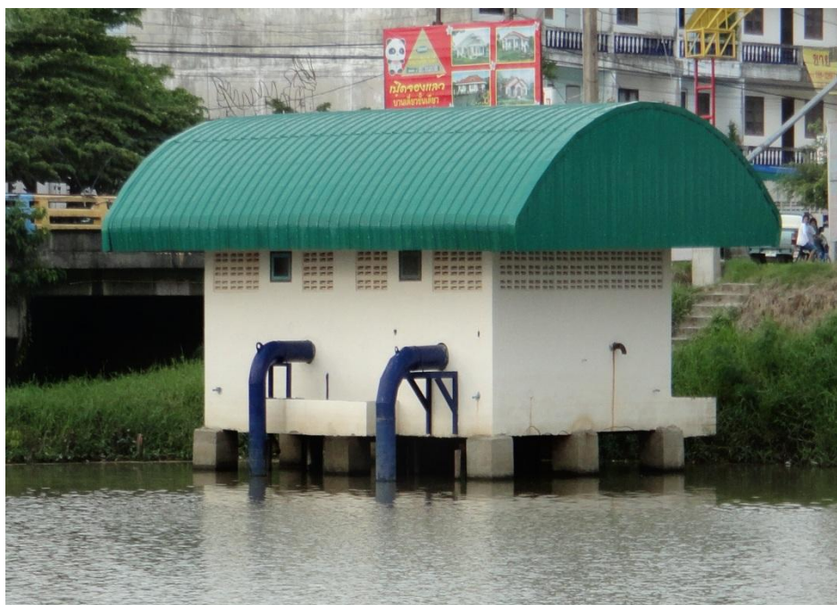
ภาพที่ 4.7 สถานีสูบน้ำด้วยไฟฟ้าหนองท่ากะสาว (โครงการสูบน้ำด้วยไฟฟ้าพร้อมระบบท่อส่งน้ำ หนองท่ากะสาว – อ่างเก็บน้ำห้วยมะเฟือง)
